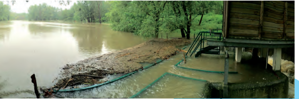
Bassin des Damoiseaux en charge © AESN
